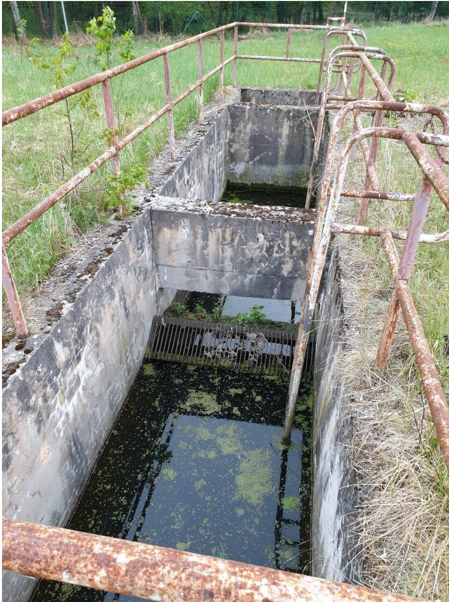
Abbildung 28: Die einzige wasserführende Struktur (Betonbecken) stellt keinen geeigneten aquatischen Lebensraum für Amphibien dar. Ein Entweichen ist unmöglich (Fallenwirkung) (Foto Grünspektrum, 16.05.2023).
